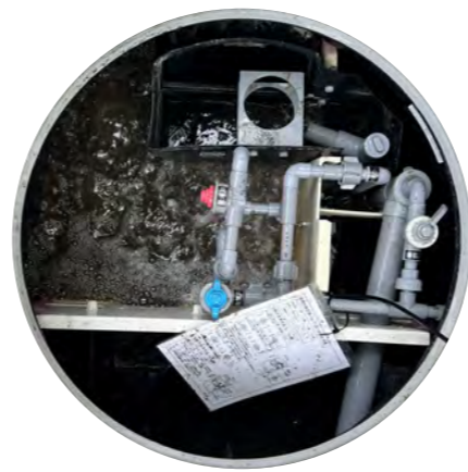
水の透明度が高く水質が良好な浄化槽
