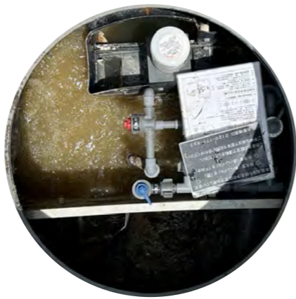
水が濁り水質悪化した浄化槽
