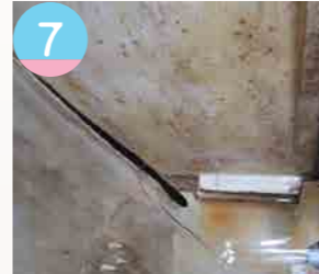
亀裂箇所特定
