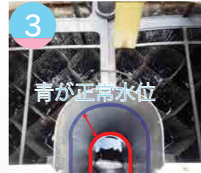
漏水・水位低下
