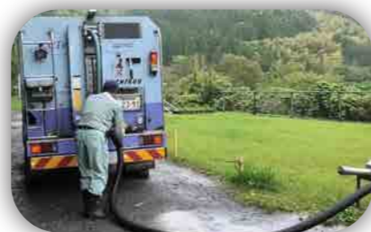
【伊集院地区中継タンク】
